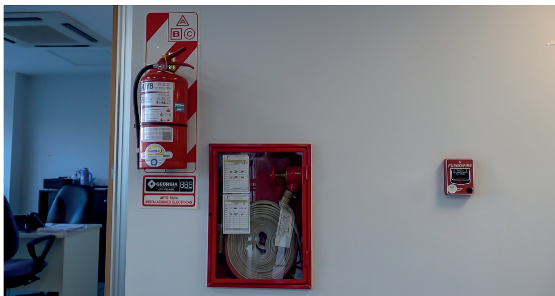
Matafuego. Establecimiento Fijo. Pulsador de Alarma. Fuente: SRT
